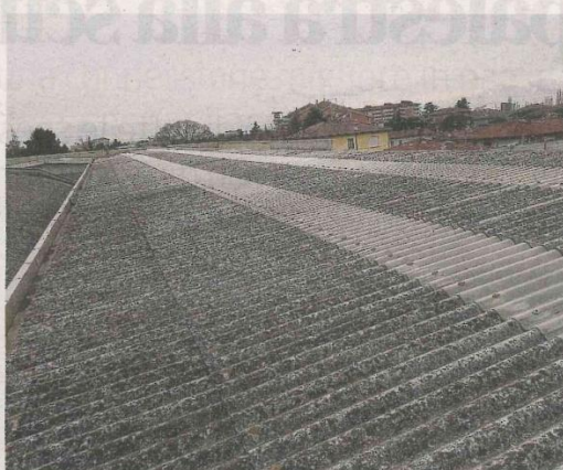
A Vigliano il Comune deve rimuovere l'amianto dal tetto della palestra
